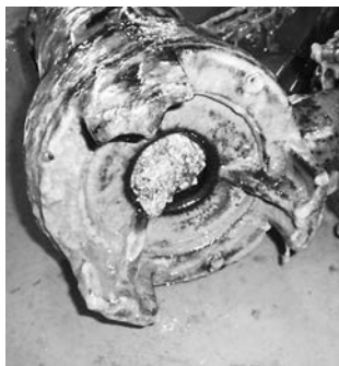
三春水環境センターのポンプ閉塞のようす
