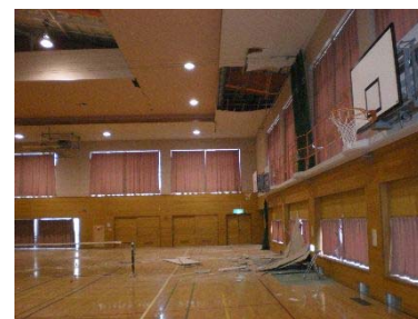
（天井が落下した町立沢石中学校体育館）
