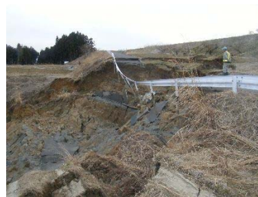
（崩落した町道西方後作線の区間）
